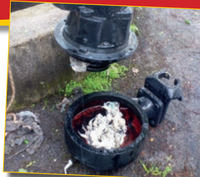
Verstopfung einer Pumpenanlage durch Feuchttücher
