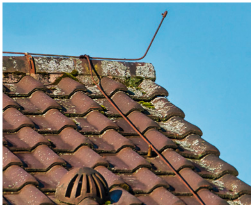
Fangeinrichtung einer Blitzschutzanlage
