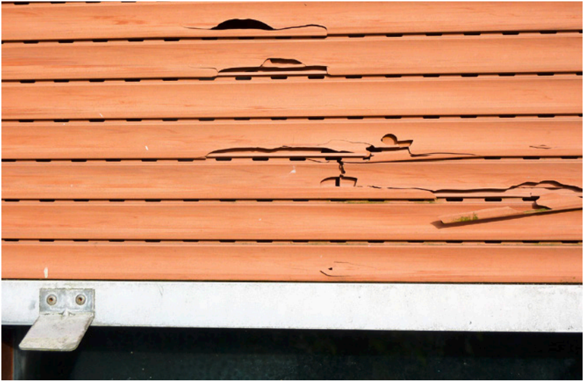
Beschädigter Rollladen aus Kunststoff nach Hagelschlag
