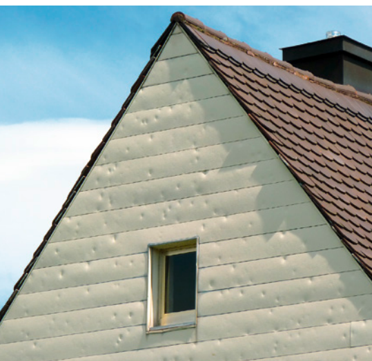
Durch Hagelschlag verformte Fassadenverkleidung aus Metall
