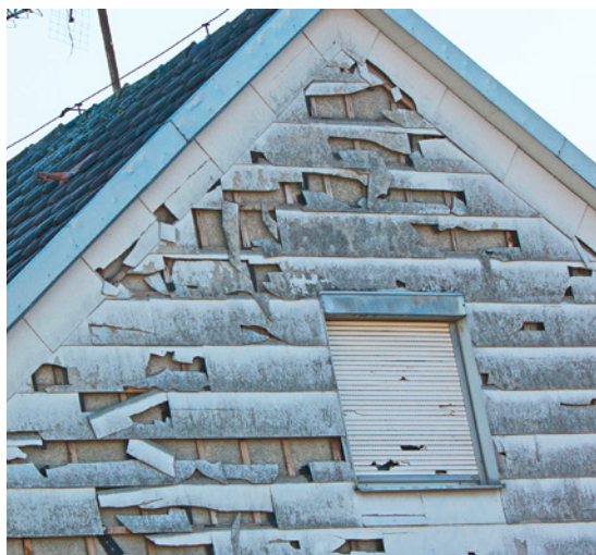
Durch Hagelschlag bruchgeschädigte Fassadenverkleidung aus Faserzementplatten
